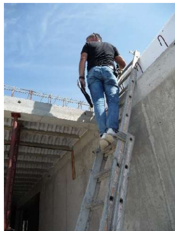
Illustration de situation de danger de chute de hauteur fréquemment constatée sur les chantiers et à l'origine de nombreux accidents graves et mortels
